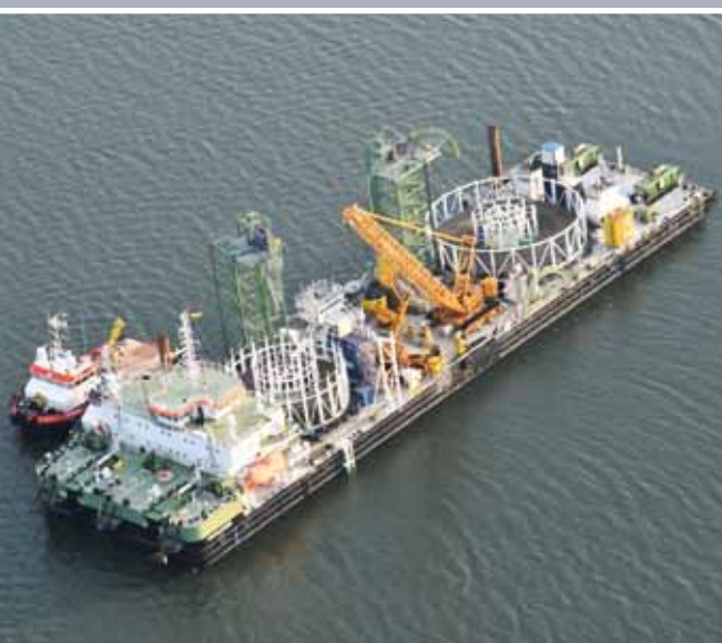
Kabelverlegung ist Großtechnik. Das Verleges Schiff „BoDo Constructor“, hier am 26. Juli am Tertius-Sand, ist 120 Meter lang und 32 Meter breit und kann Kabel bis zu 5000 Tonnen Gesamtgewicht transportieren und verlegen (© GFN).
